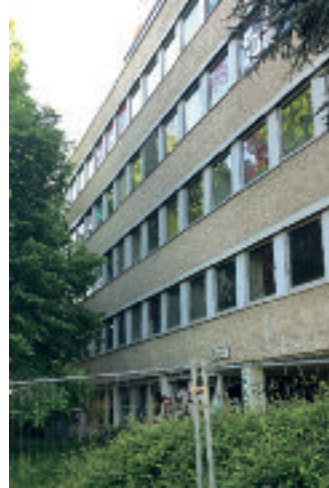
Die Gebäude in der Karl-Marx-Allee stehen seit 2016 leer und verfallen
